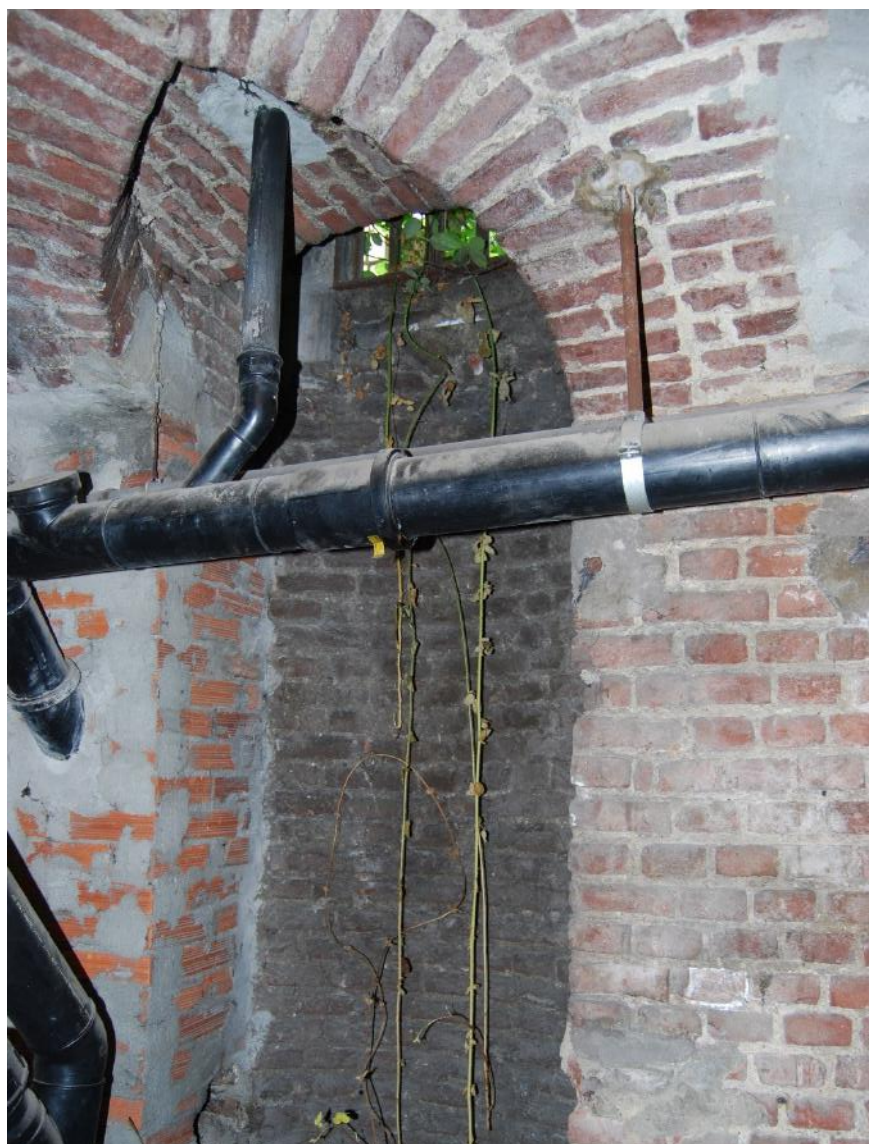
Figura 5, infernotto del piano seminterrato. Da sottolineare la buona fattura della muratura ancora originale, ad eccezione delle implementazioni impiantistiche successive.
